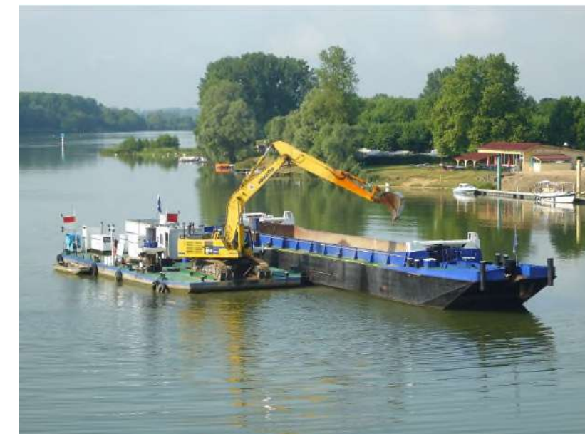
Fig. 122. Exemple de matériels utilisés pour le dragage et le chargement des produits de démolition dans une barge
